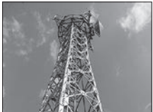
デジタル無線中継基地局(大峰山)
